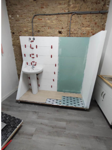
Fig 4: Vista frontal de la instalación construida, donde se puede apreciar la instalación de fontanería y saneamiento de un cuarto de baño (en proceso), así como la ejecución de un revestimiento de alicatado y un pavimento flotante
