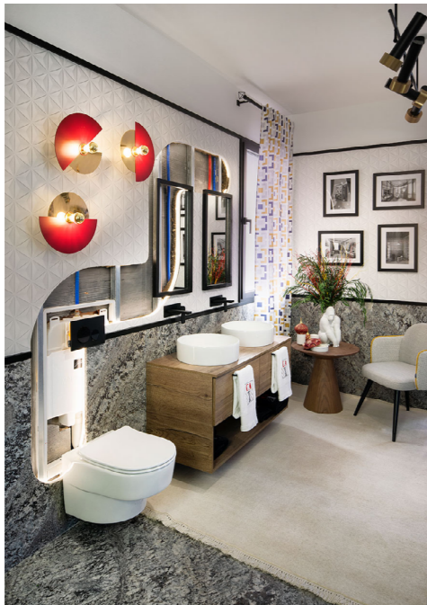
Fig 1: Vista del Espacio COATM, en la 30ª Edición de Casa Decor en Madrid, obra de César Ávila Rodríguez (2022). En la imagen se puede apreciar el interior del tabique mostrando el interior y el funcionamiento de las instalaciones.
