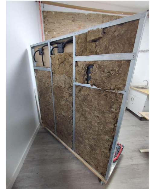
Fig 3: Vista posterior de la instalación construida, donde se puede apreciar la instalación eléctrica, así como la ejecución de la tabiquería autoportante de placas de yeso laminado con aislamiento en su interior.
