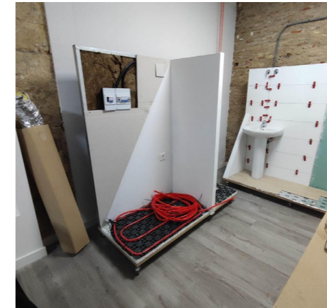
Fig 2: Vista de las instalaciones construidas. A la izquierda se puede observar un espacio compartimentado donde se muestra parte de la instalación eléctrica, así como un sistema de climatización mediante suelo radiante.
